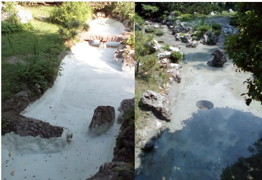
Beton aljzatú tó utólagos szigetelése: 1. Bentonitos duzzadó szalag és szerelőragasztó bedolgozása a dilatációs hézagokba, repedésekbe. 2. Holkerezés és kelőstítés. 3. Flexibilis vízszigetelő habarcs felhordása. 4. Üvegszálal szövet rögzítése kenhető vízszigetelő habarcsréteg alá.
